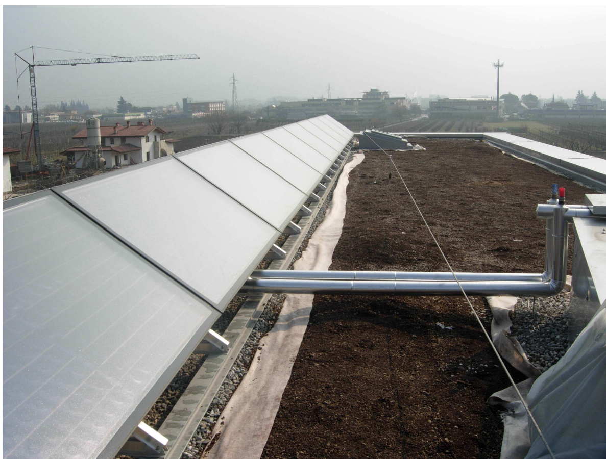
Figura 3. Pannelli solari termici su tetto verde in fase di ultimazione (Habitech)
