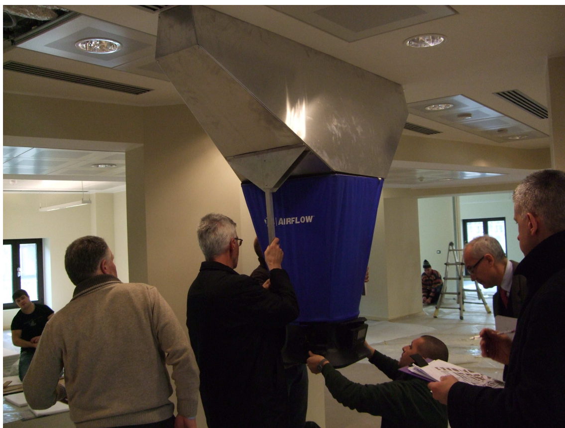
Figura 11. Misura di portata d'aria.
