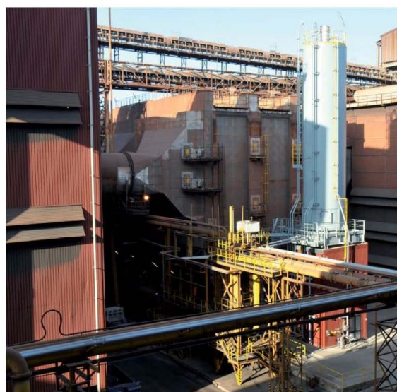
Nuovo impianto di iniezione carbone per l'abbattimento della diossina
